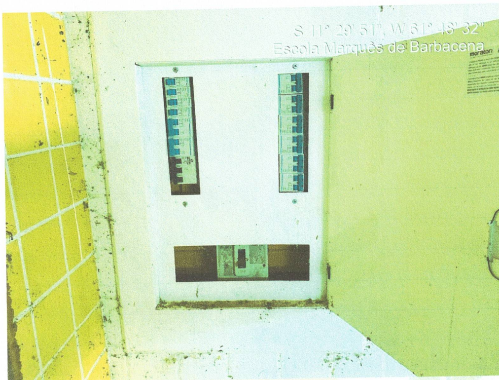
Quadro de distribuição (faltando a conclusão das instalações elétricas)
